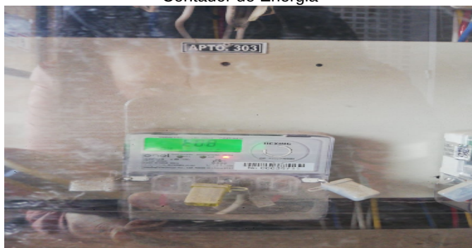
Contador de Energia
