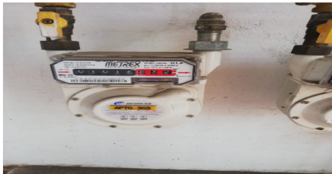
Contador de Gas
