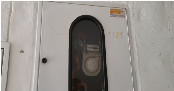
Contador de Gas
