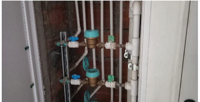
Contador de Agua
