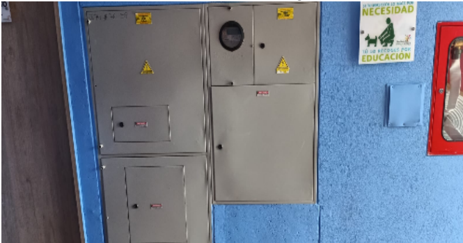
Contador de Energia
