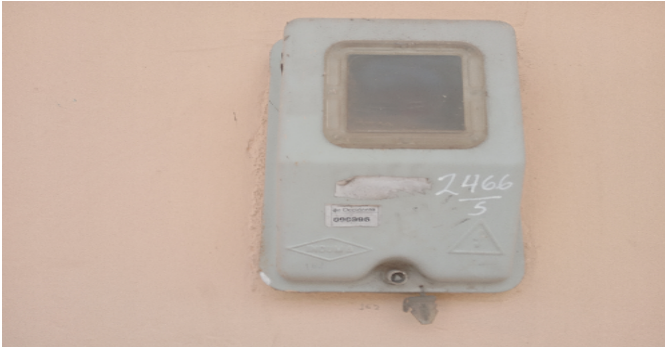
Contador de Energia
