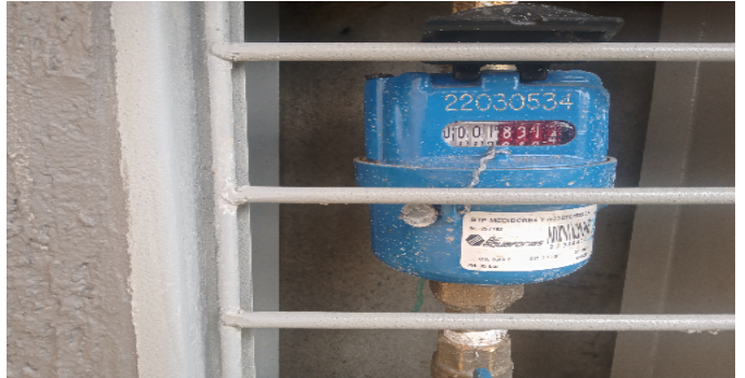
Contador de Agua
