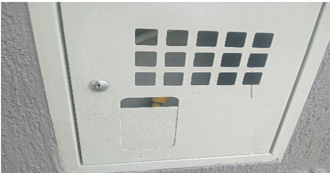
Contador de Gas
