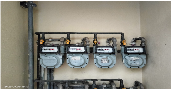
Contador de Gas
