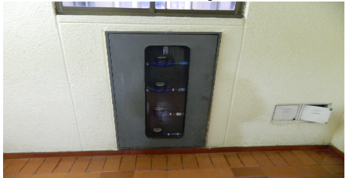
Contador de Agua
