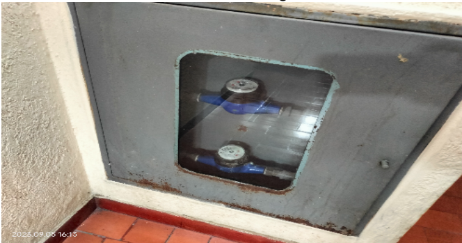
Contador de Agua
