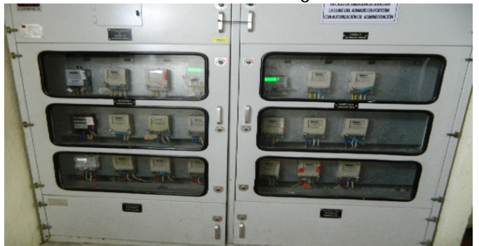
Contador de Energia
