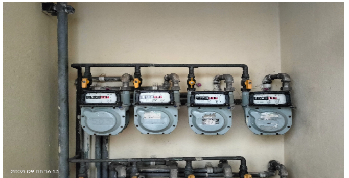
Contador de Gas
