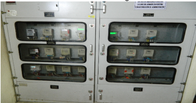
Contador de Energia
