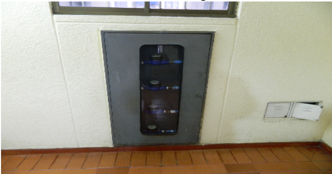
Contador de Agua
