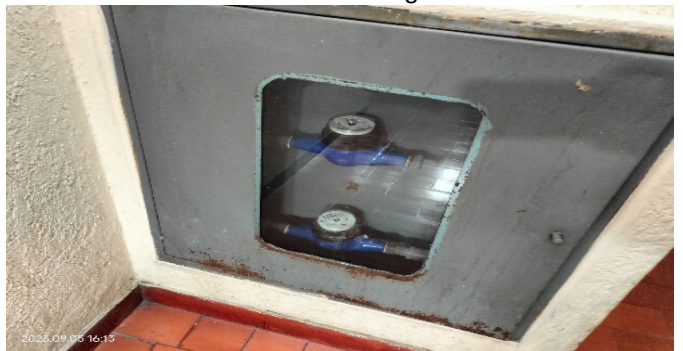
Contador de Agua
