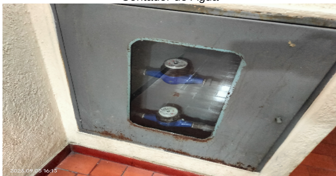
Contador de Agua
