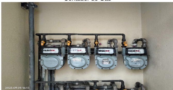
Contador de Gas
