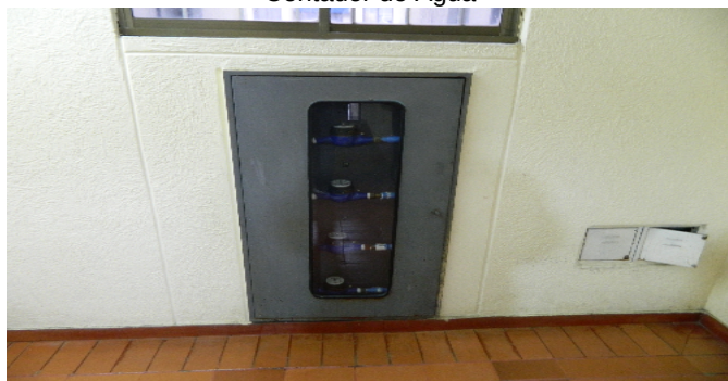
Contador de Agua
