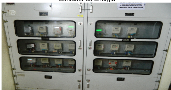
Contador de Energia
