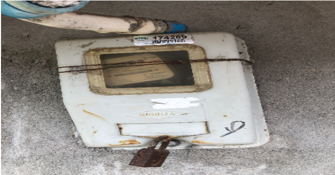
Contador de Energia
