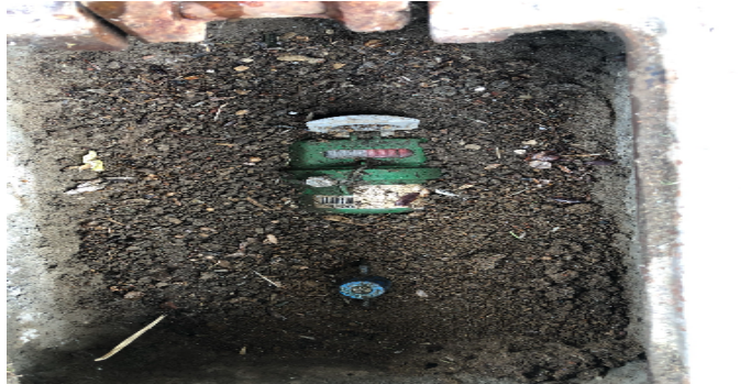
Contador de Agua
