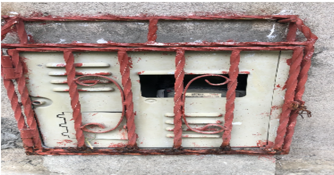
Contador de Gas
