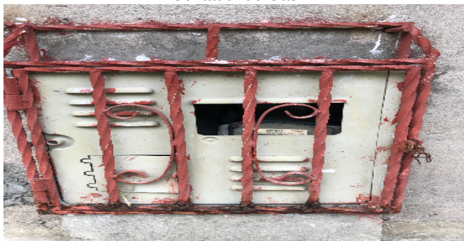
Contador de Gas
