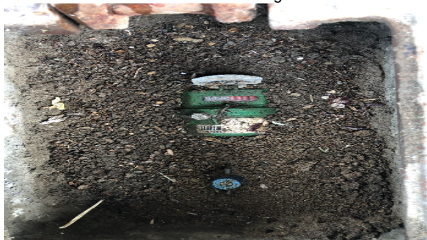
Contador de Agua
