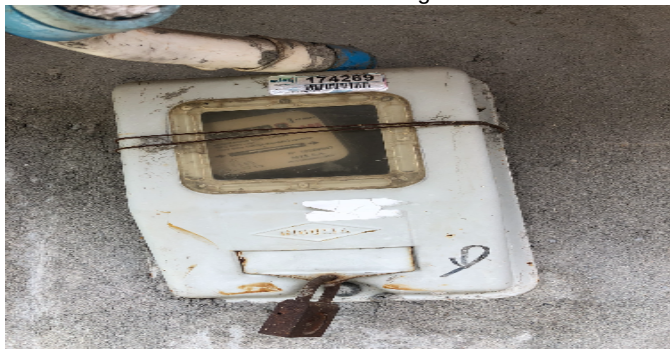
Contador de Energia
