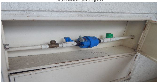
Contador de Agua
