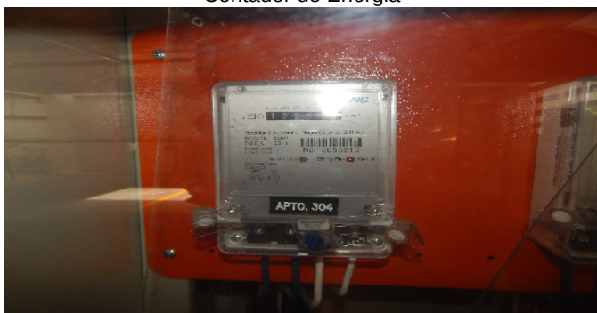
Contador de Energia
