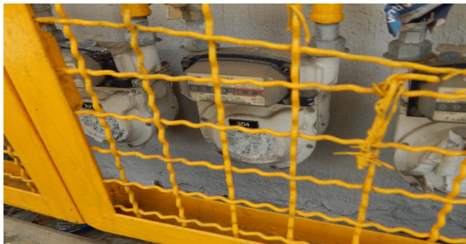
Contador de Gas
