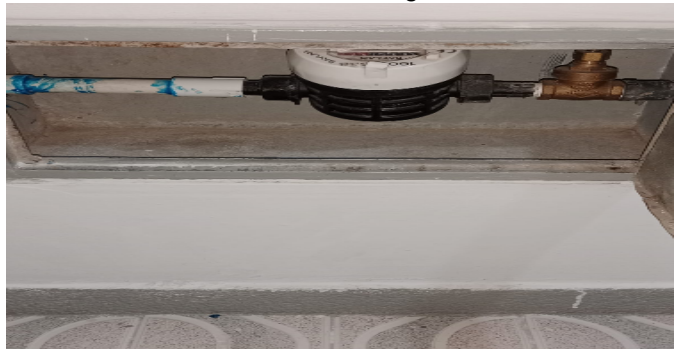
Contador de Agua
