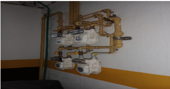
Contador de Gas
