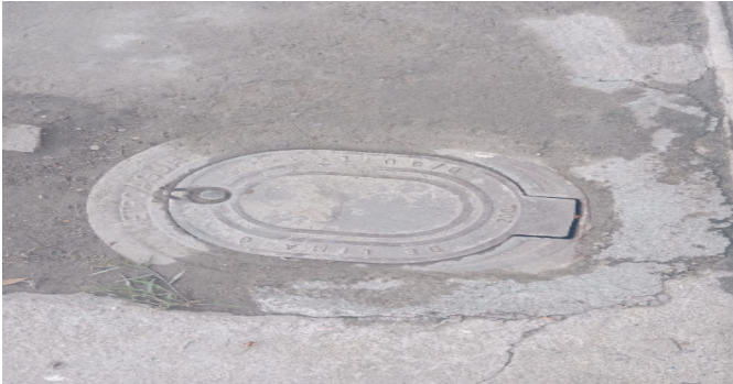
Contador de Agua
