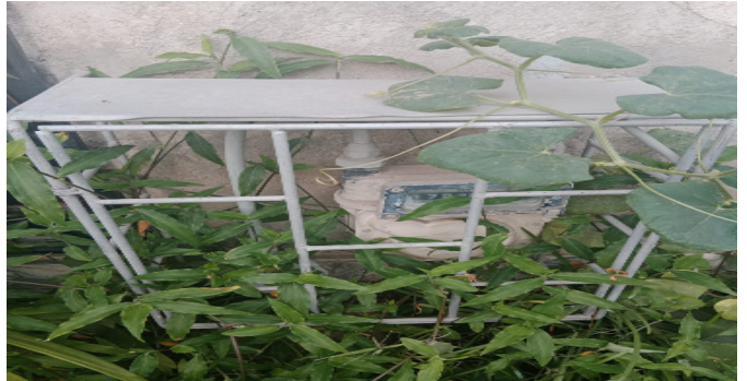
Contador de Gas
