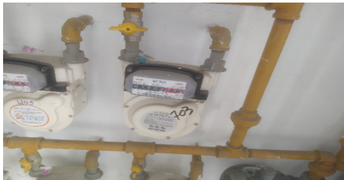
Contador de Gas
