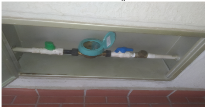
Contador de Agua
