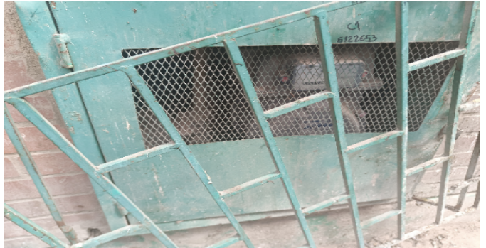
Contador de Gas
