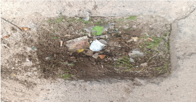
Contador de Agua
