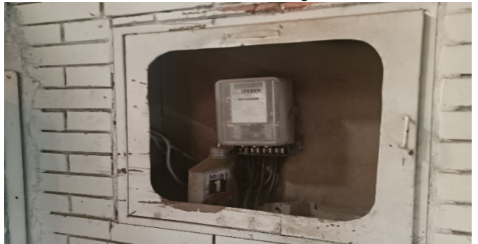
Contador de Energia
