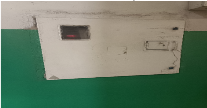
Contador de Energia
