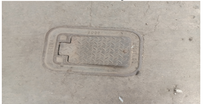
Contador de Agua
