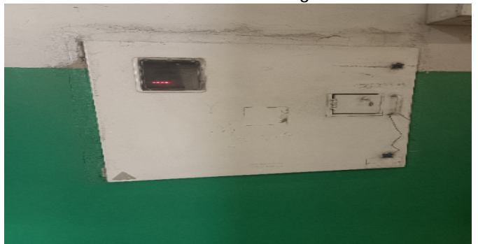
Contador de Energia
