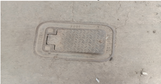
Contador de Agua
