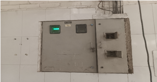
Contador de Energia
