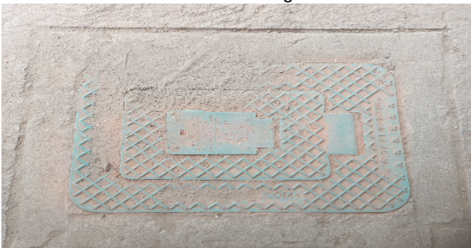
Contador de Agua
