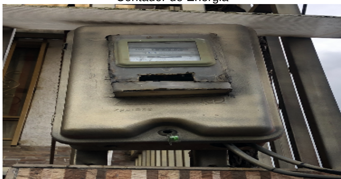
Contador de Energia
