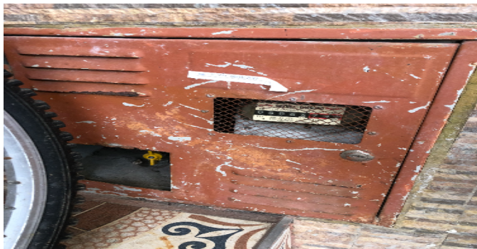
Contador de Gas
