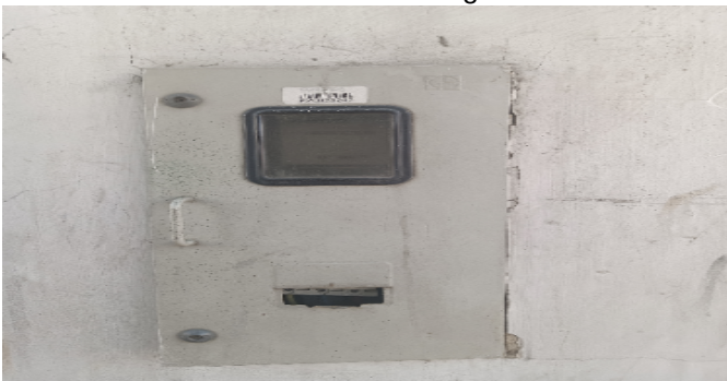
Contador de Energia
