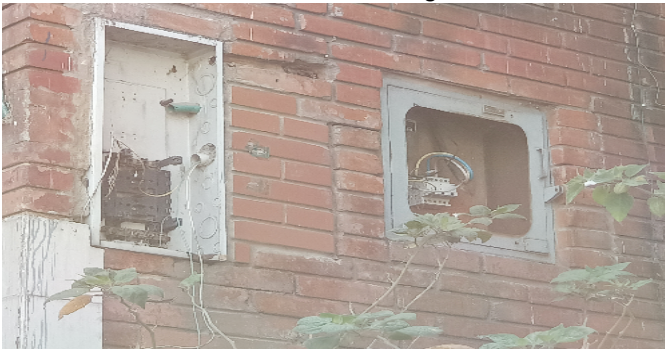
Contador de Energia
