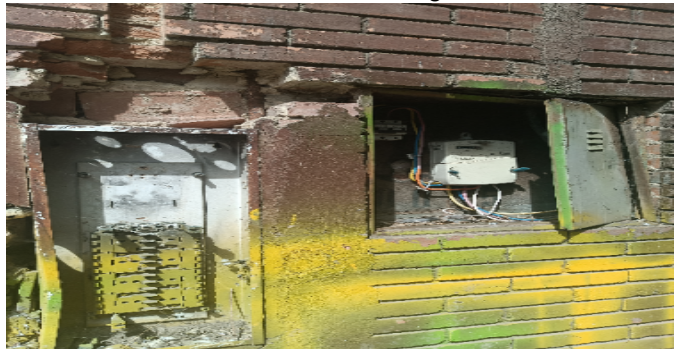
Contador de Energia
