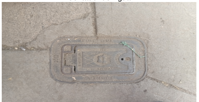
Contador de Agua
