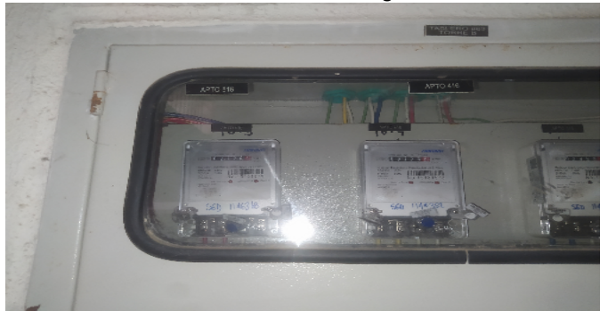
Contador de Energia
