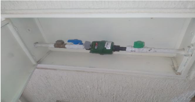
Contador de Agua
