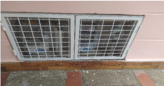
Contador de Gas
