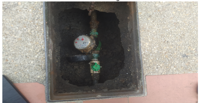
Contador de Agua
