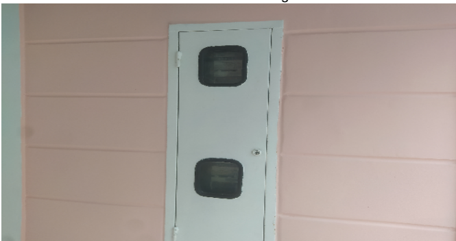
Contador de Energia
