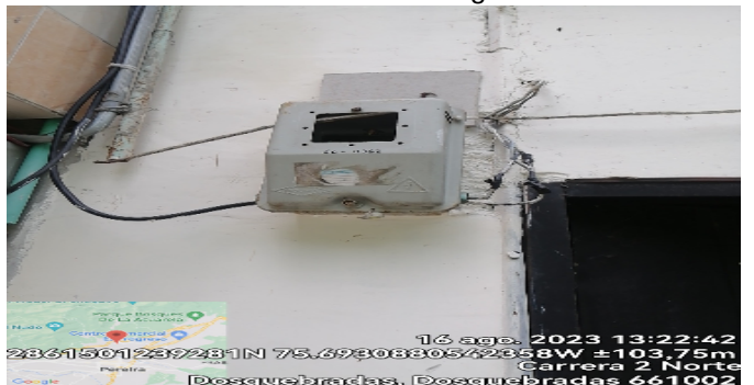
Contador de Energia
