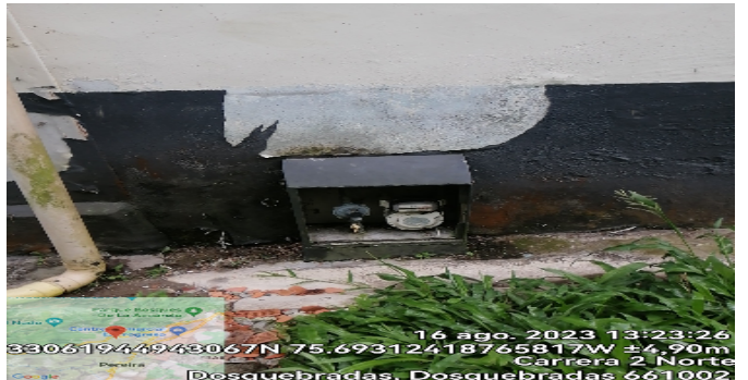
Contador de Gas
