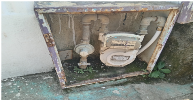
Contador de Gas
