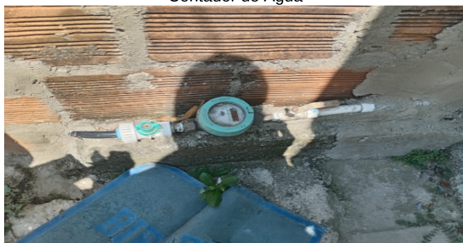
Contador de Agua
