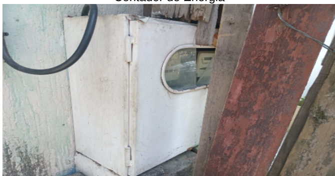
Contador de Energia
