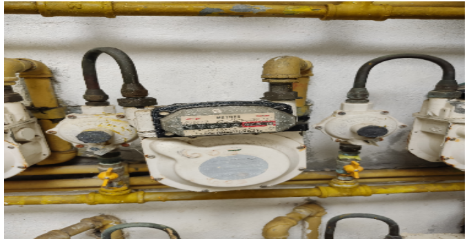
Contador de Gas
