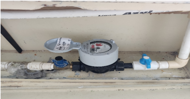
Contador de Agua
