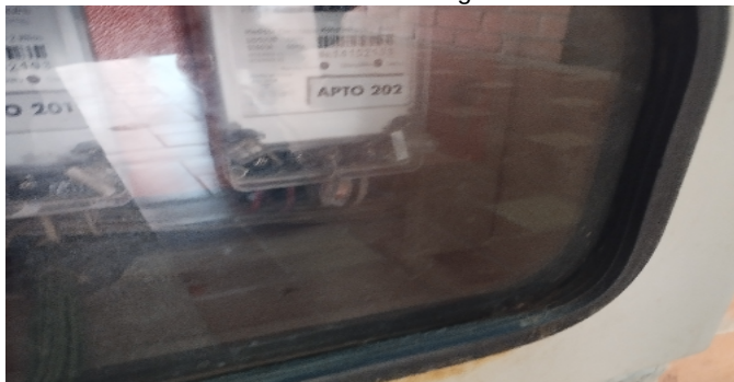
Contador de Energia
