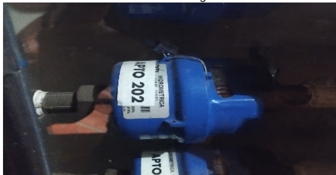
Contador de Agua
