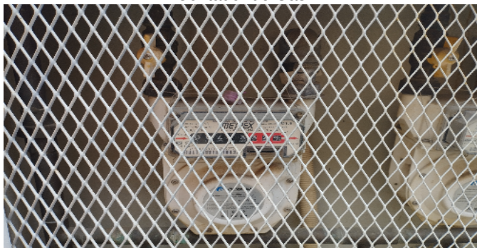
Contador de Gas
