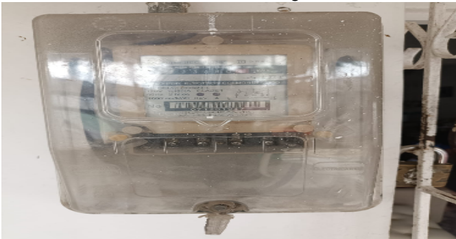
Contador de Energia
