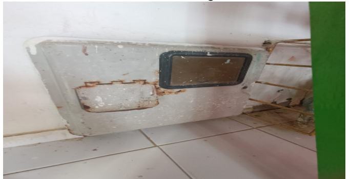
Contador de Agua
