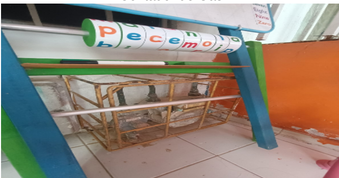
Contador de Gas
