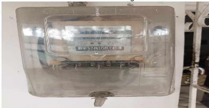
Contador de Energia
