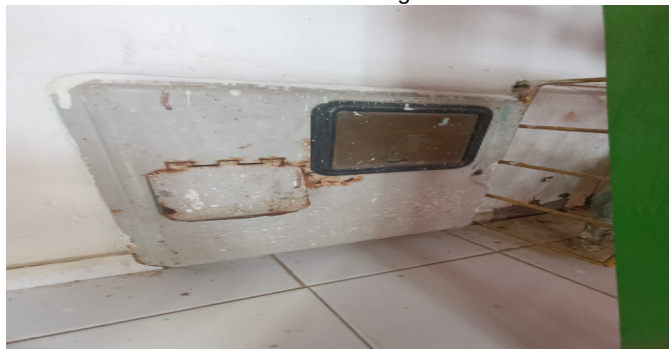
Contador de Agua
