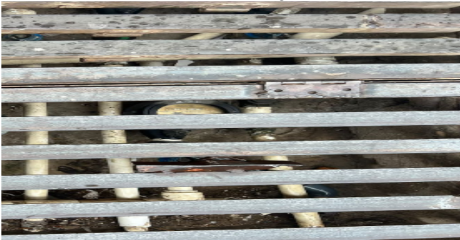
Contador de Agua
