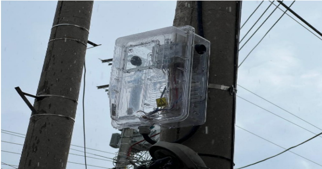
Contador de Energia
