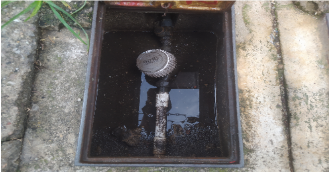
Contador de Agua
