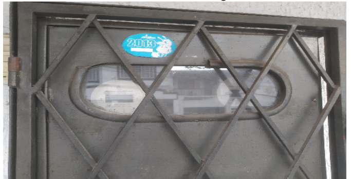
Contador de Energia
