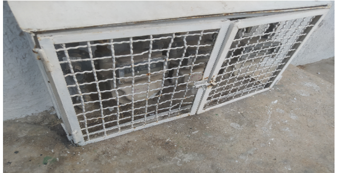
Contador de Gas
