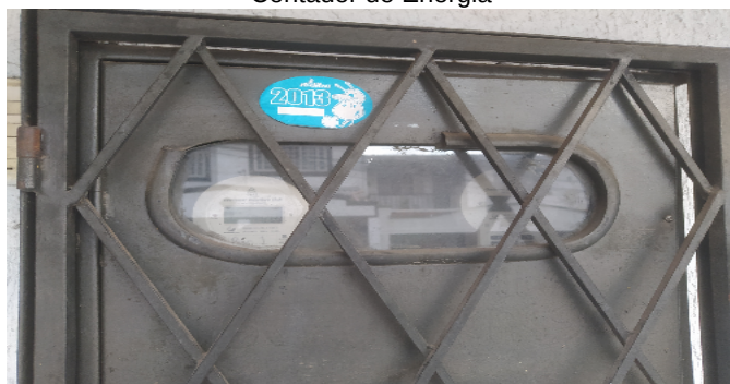
Contador de Energia
