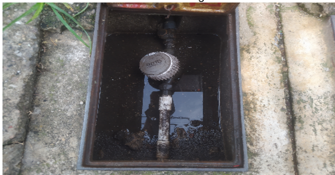
Contador de Agua
