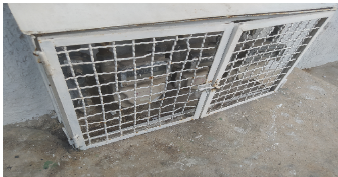
Contador de Gas
