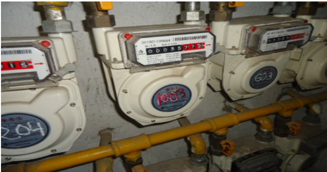
Contador de Gas
