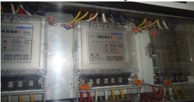
Contador de Energia
