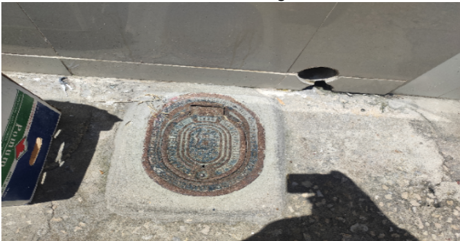
Contador de Agua
