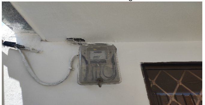
Contador de Energia
