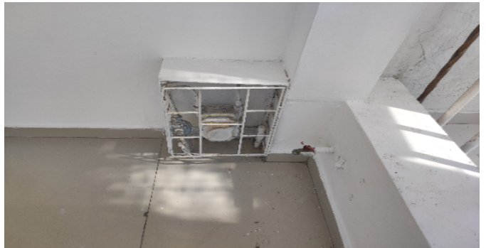
Contador de Gas
