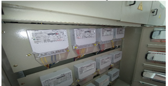
Contador de Energia
