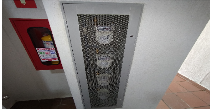
Contador de Gas
