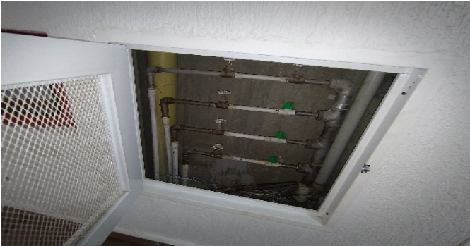
Contador de Agua
