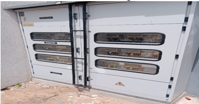
Contador de Energia
