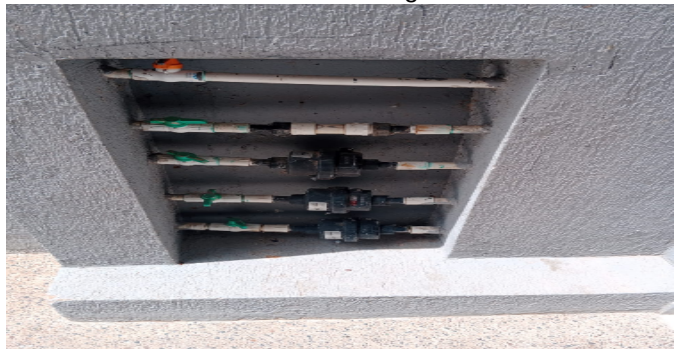
Contador de Agua
