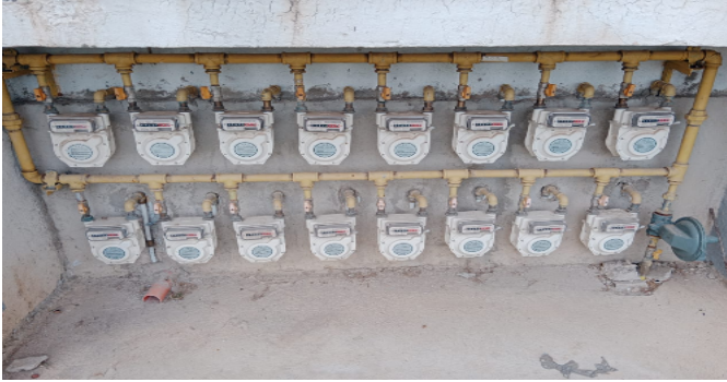
Contador de Gas
