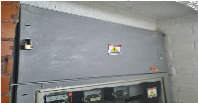
Contador de Energia
