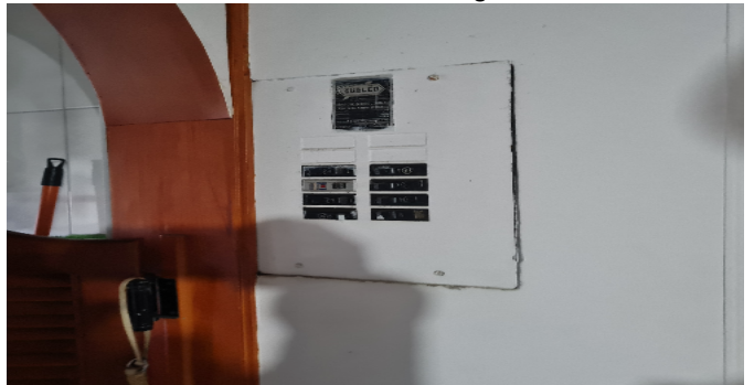
Contador de Energia
