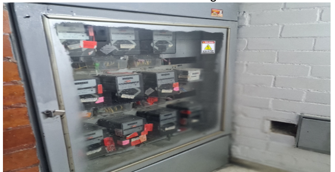
Contador de Energia
