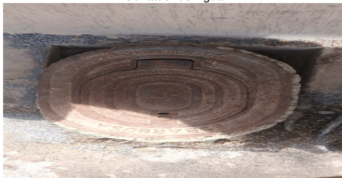
Contador de Agua
