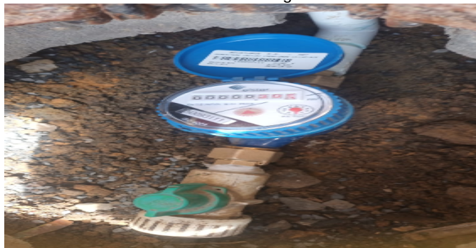
Contador de Agua
