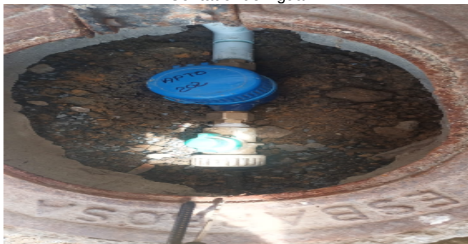
Contador de Agua
