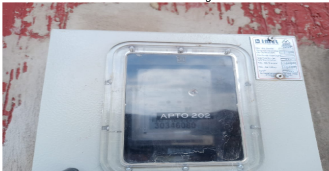
Contador de Energia
