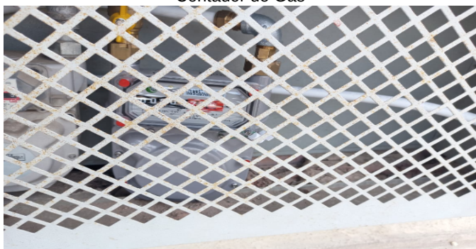
Contador de Gas
