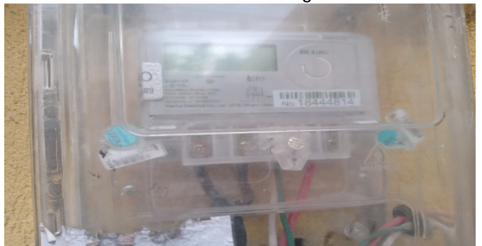
Contador de Energia
