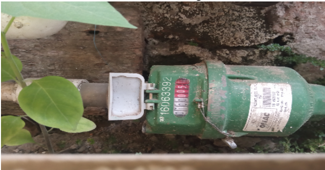
Contador de Agua
