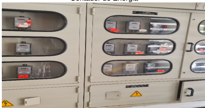
Contador de Energia
