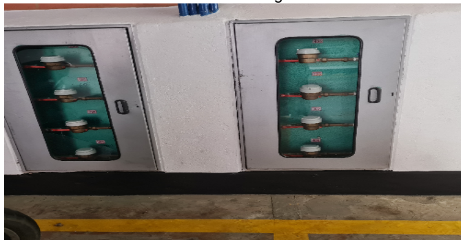
Contador de Agua
