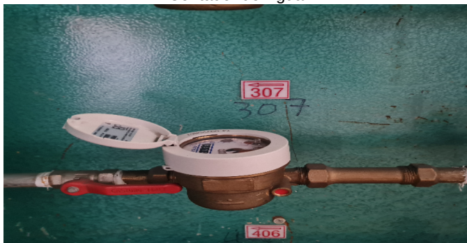
Contador de Agua
