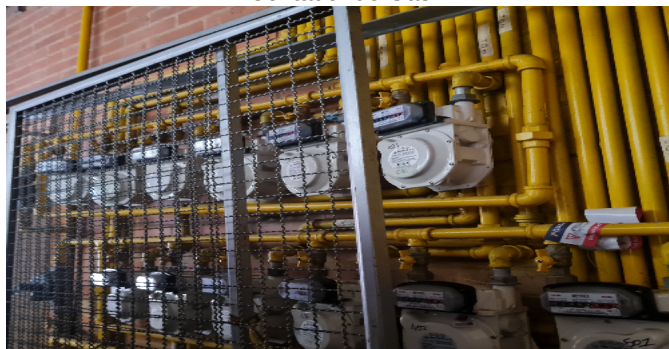
Contador de Gas
