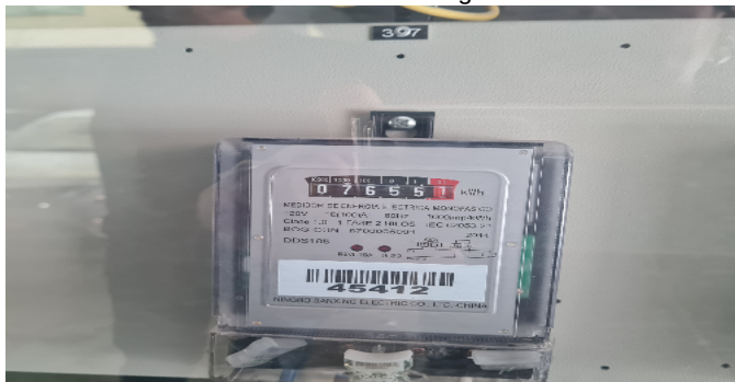
Contador de Energia
