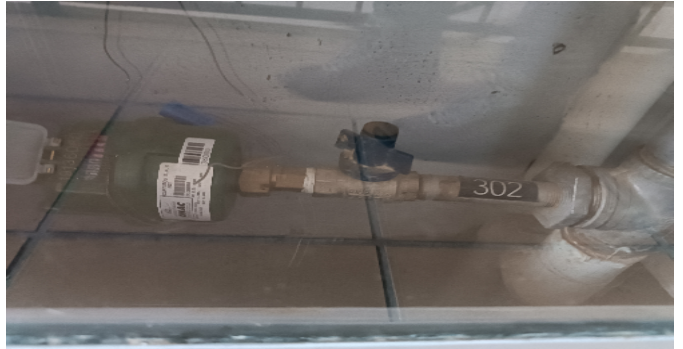
Contador de Agua
