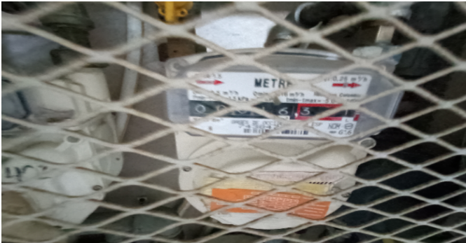
Contador de Gas
