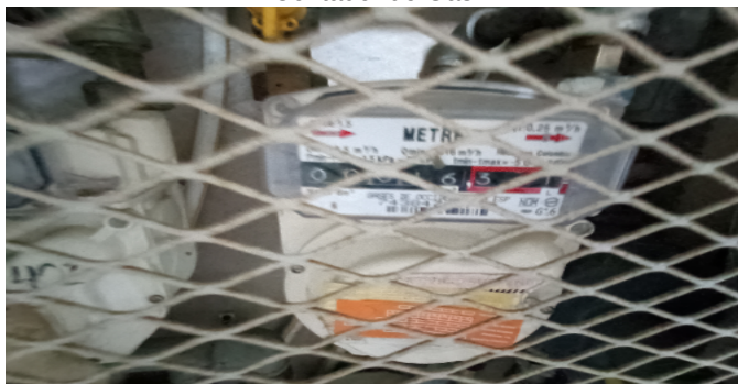
Contador de Gas
