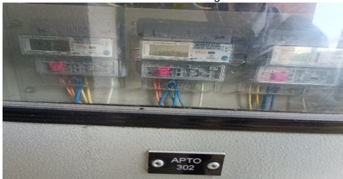
Contador de Energia
