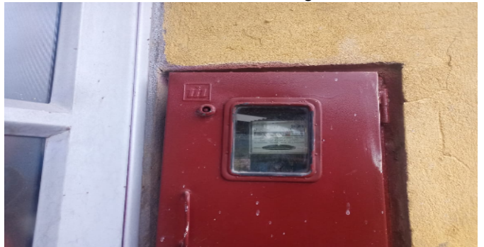
Contador de Energia
