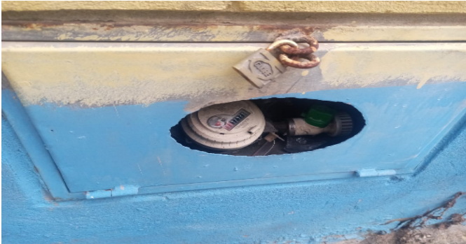
Contador de Agua
