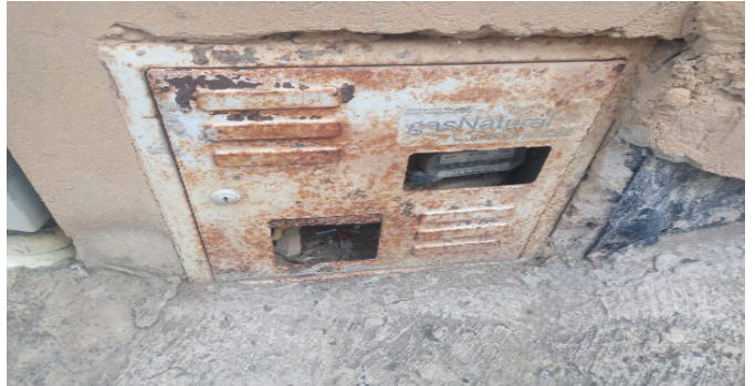
Contador de Gas
