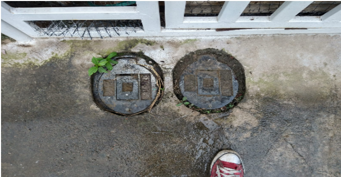
Contador de Agua
