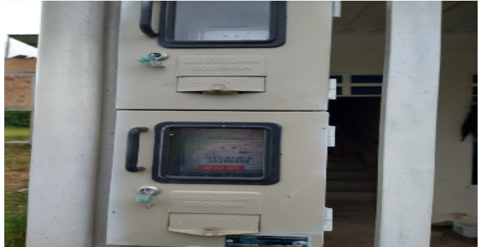
Contador de Energia
