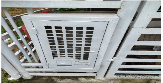
Contador de Gas
