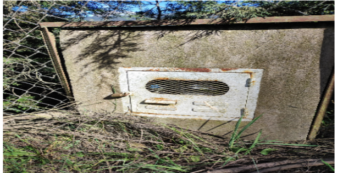
Contador de Gas
