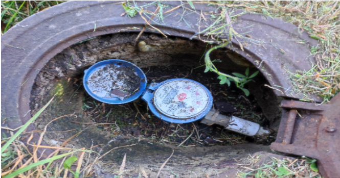
Contador de Agua
