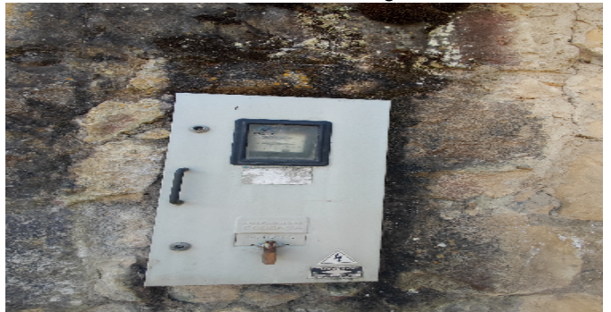
Contador de Energia
