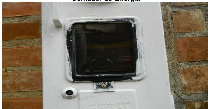
Contador de Energia
