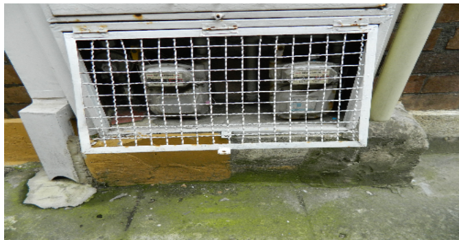
Contador de Gas
