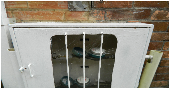
Contador de Agua
