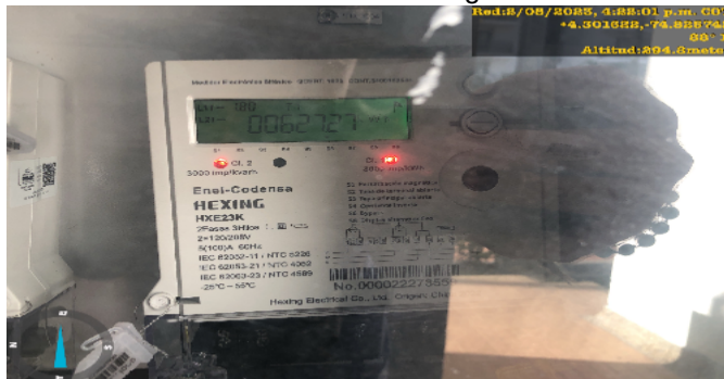
Contador de Energia
