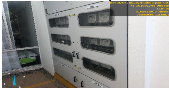
Contador de Energia
