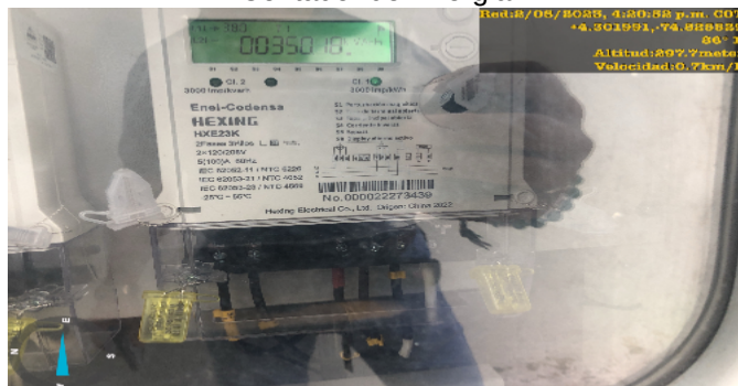
Contador de Energia
