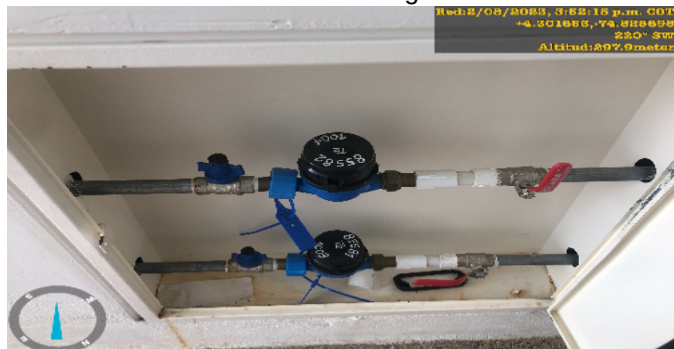
Contador de Agua
