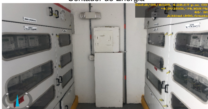
Contador de Energia
