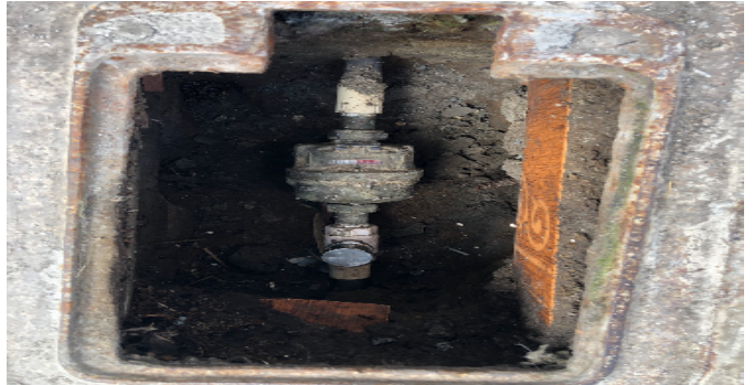
Contador de Agua
