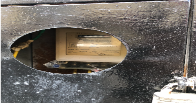
Contador de Energia
