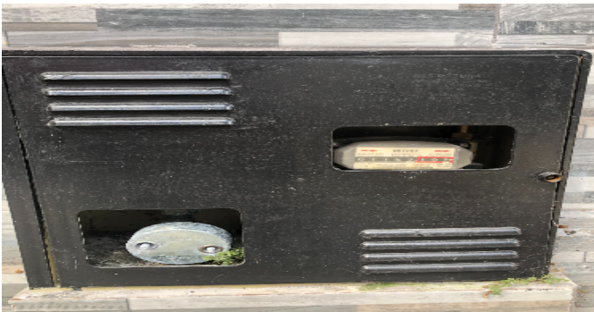
Contador de Gas
