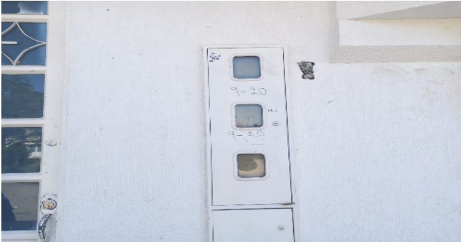
Contador de Energia
