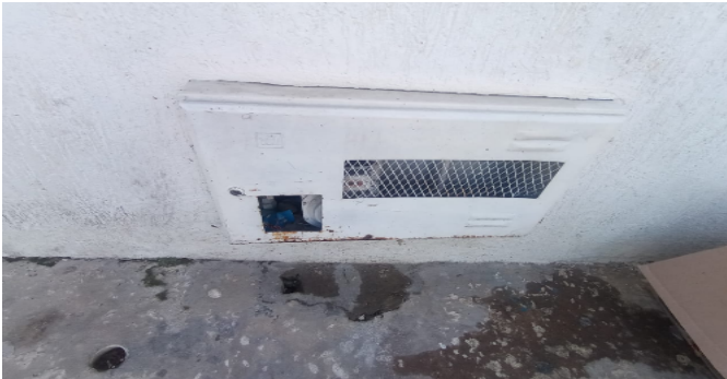
Contador de Gas
