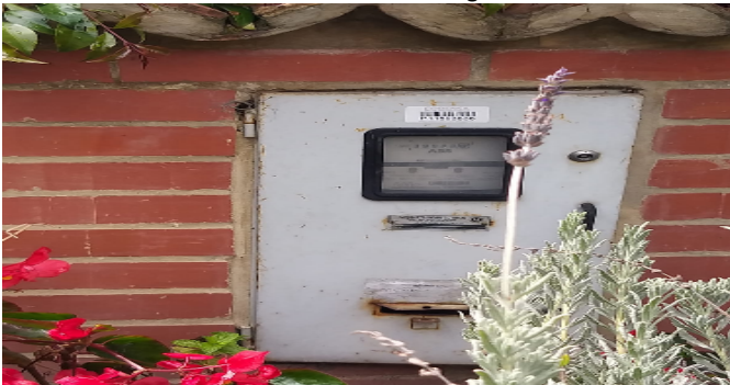
Contador de Energia
