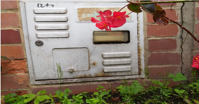
Contador de Gas
