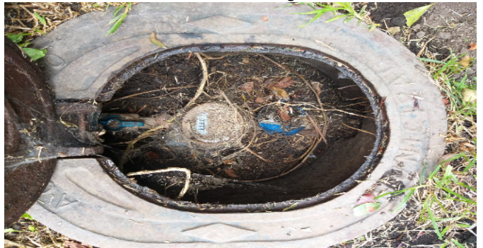
Contador de Agua
