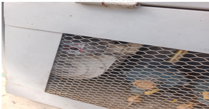
Contador de Gas
