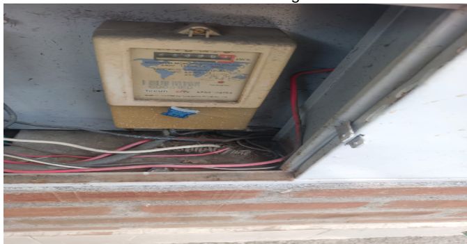
Contador de Energia
