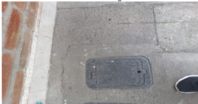
Contador de Agua
